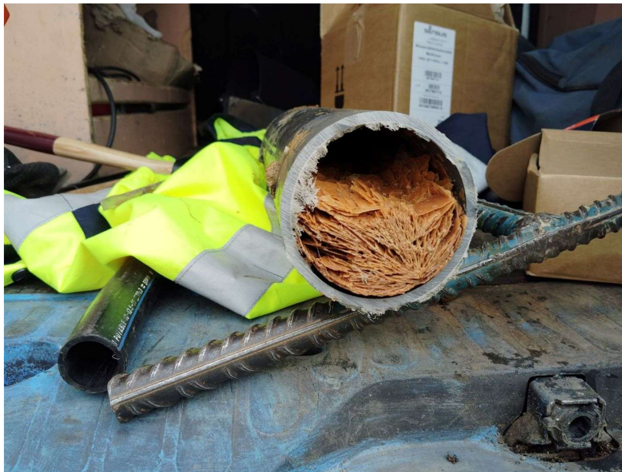
SAINTE MARTHE canalisation bouchée par du calcaire
